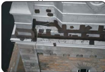
Goudron apposé sur les fissures.
